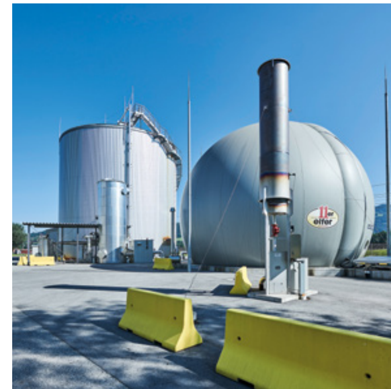
Die Biogasanlage des Unternehmens 11er – überschüssiges Biomethan wird ins Erdgasnetz eingespeist und steht dort den Vorarlberger Biogaskunden zur Verfügung.
